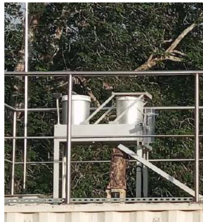
Fig. 6.7. Foto del muestreador de depósito instalado en el techo del contenedor del OMECCA.
